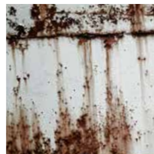
Voorkomen van roest en corrosie
